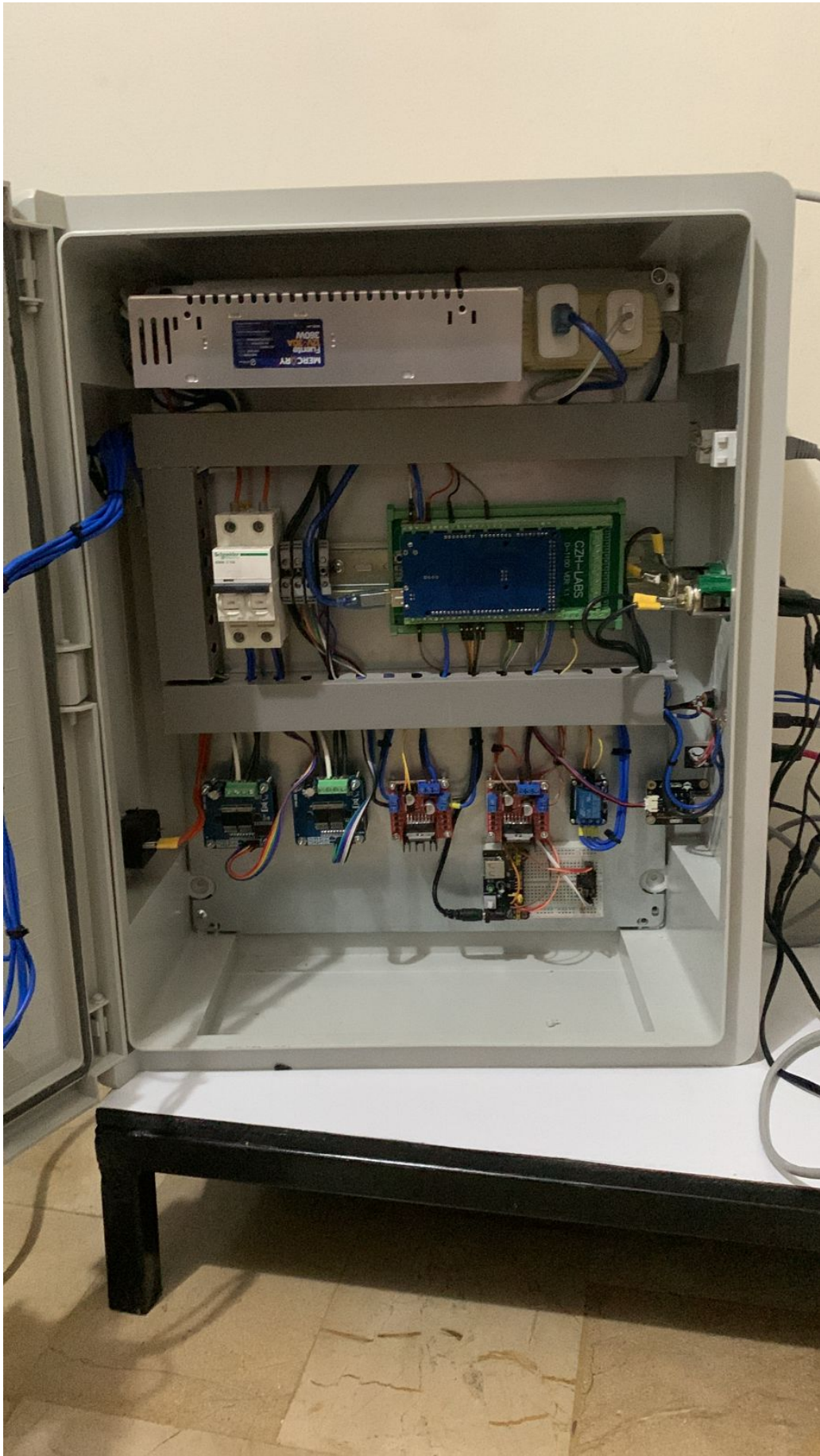
Figura 80: Conexiones internas del tablero eléctrico
