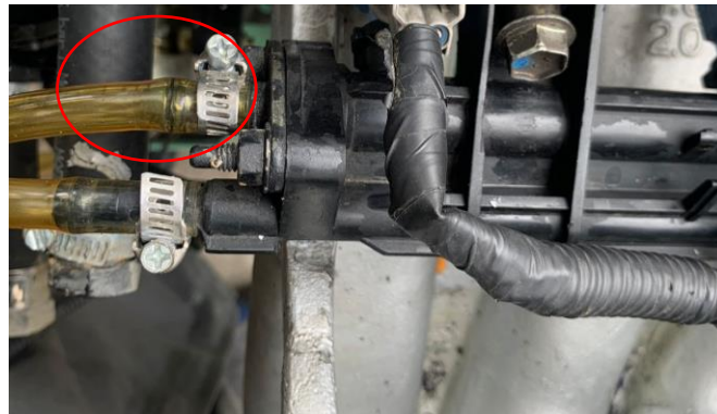
Ilustración 2.5: Cañería de alta presión
