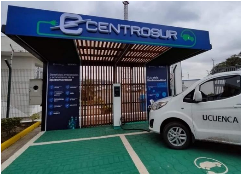
Figura 50. Estación de recarga para vehículos eléctricos.
