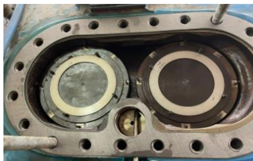
Figura 9. Inspección cantidad y evaluación de aceite
