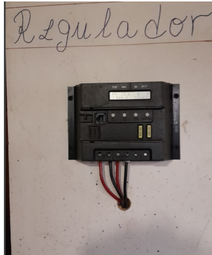
Figura 3.4: Instalación del regulador de carga del sistema.
