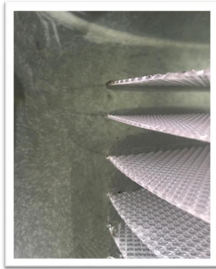
Figura 5 Agua residual en contacto con los biodiscos. Fuente: Autores.
