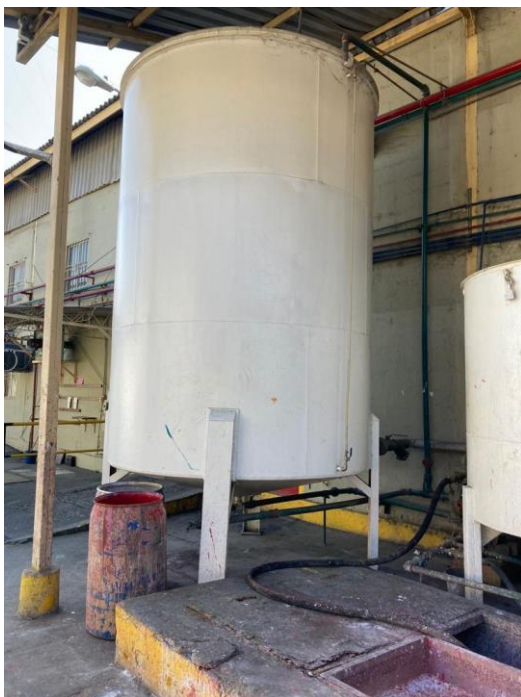
Tanque de almacenamiento de las aguas tratadas
