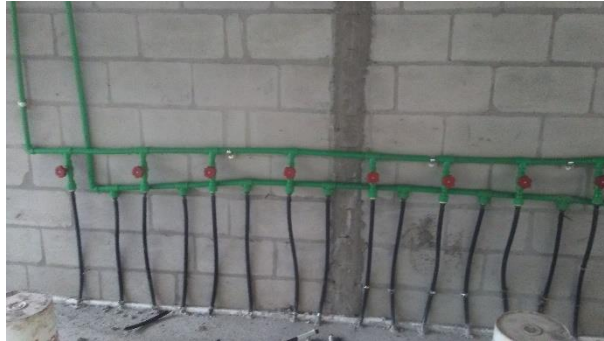
Figura A. 46 Sistema de distribución de agua [AUTOR].
