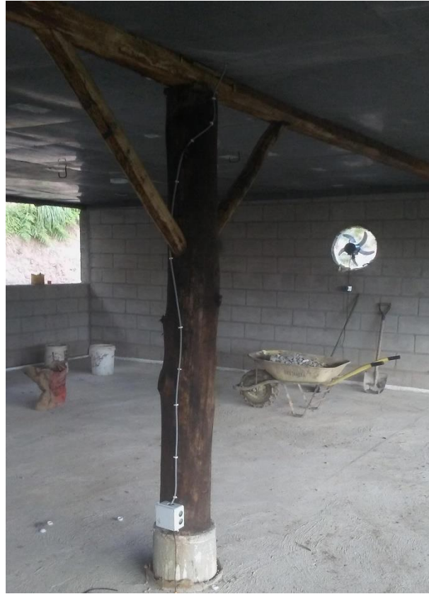
Figura A. 48. Instalación y cableado de Sensores [AUTOR].
