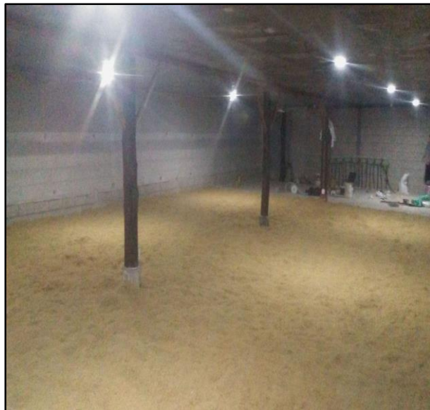
Ilustración 71. Disposición de luminarias dentro del galpón.
