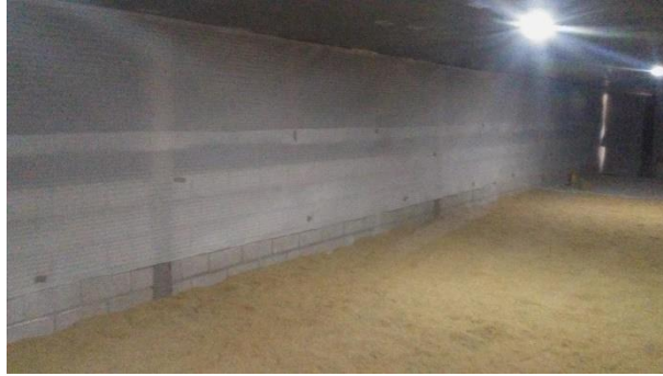
Figura A. 50 Montaje de Aislamiento Interno de paredes y preparación de la cama [AUTOR]
