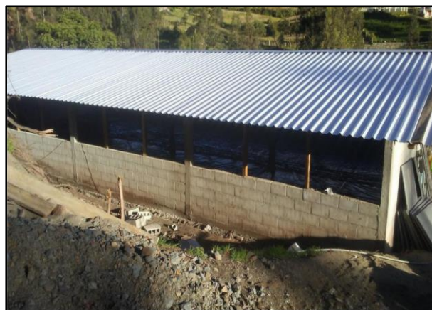
Ilustración 7. Galpón a implementar el sistema de climatización [AUTOR].
