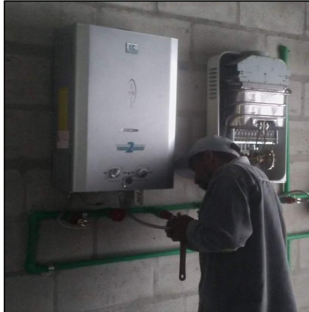
Ilustración 64. Impulsor térmico (calefón) de agua para calentar el piso radiante [AUTOR].
