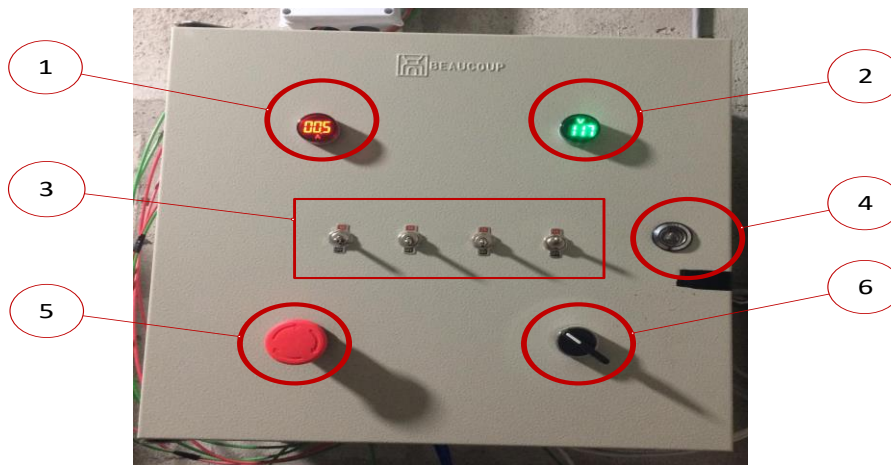
Figura A. 16. Panel de Control [AUTOR]1.- Indicador de Voltaje de alimentación. 2.- Interruptores tipo ojo de cangrejo. 3.- Cerradura manual de Llave. 4.- Interruptor de paro general o emergencia. 5.- Interruptor selector Automático o Manual.
