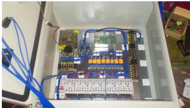
Figura A. 35 Tablero de control gabinete [AUTOR].
