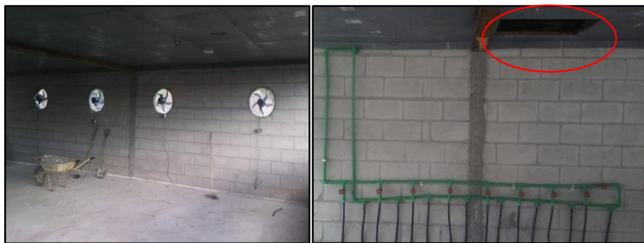
Ilustración 12. Sistema de ventilación en el galpón [AUTOR].
