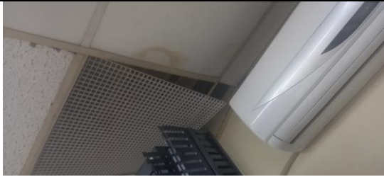
Figura 10: Fotografía del techo en mal estado.
