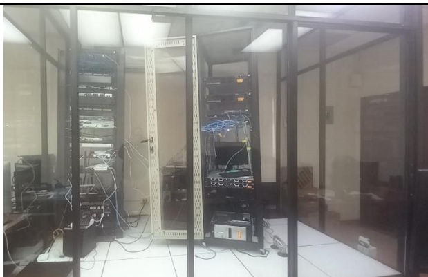
Figura 2: Fotografía del centro de procesamiento de datos.
