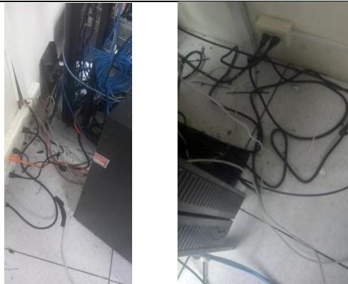
Figura 11: Fotografía de conexiones eléctricas.
