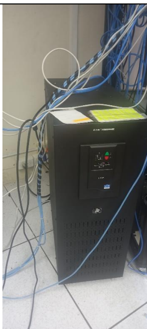
Figura 6: Fotografía del Sistema de Alimentación ininterrumpida UPS.
