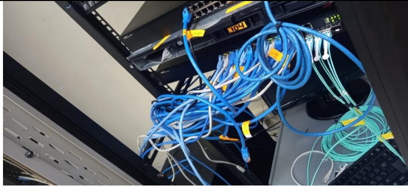
Figura 14: Fotografía de cableado de red desde el switch Core 1.
