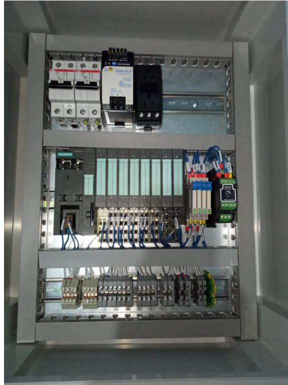
Figura 41. Tablero con marquillas
