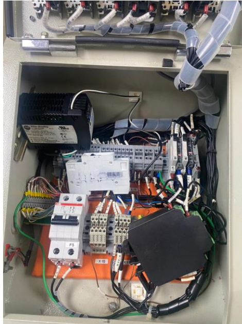
Figura 14. Tablero de control antes de desmantelar
