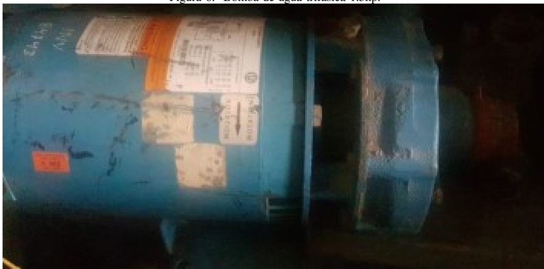
Figura 6. Bomba de agua trifásica 1.5hp.
