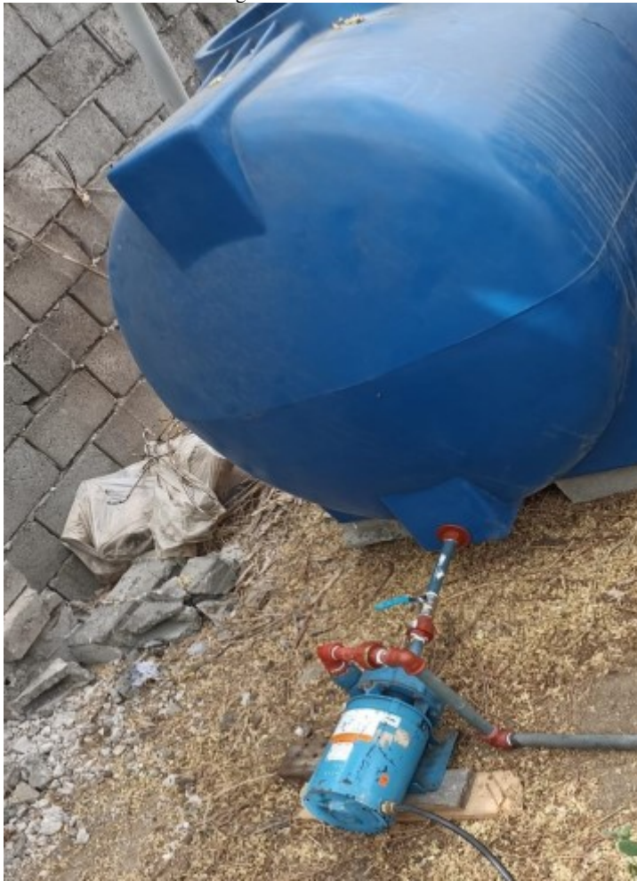
Figura 42. Conexión bomba a tubería.
