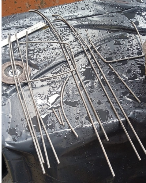
Figura 37. Cortes de varillas para los nervios del casco, por A. Sánchez y L. Suárez
