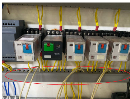
Figura 39. Canaletas de los relés
