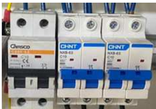
Figura 32. Breakers de seguridad [24]
