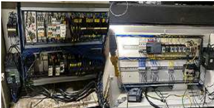
Figura 9. Panel eléctrico antes y después de la repotenciación
