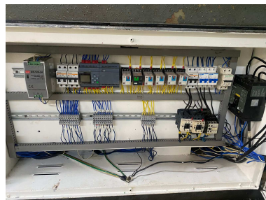
Figura 44. Panel eléctrico completo
