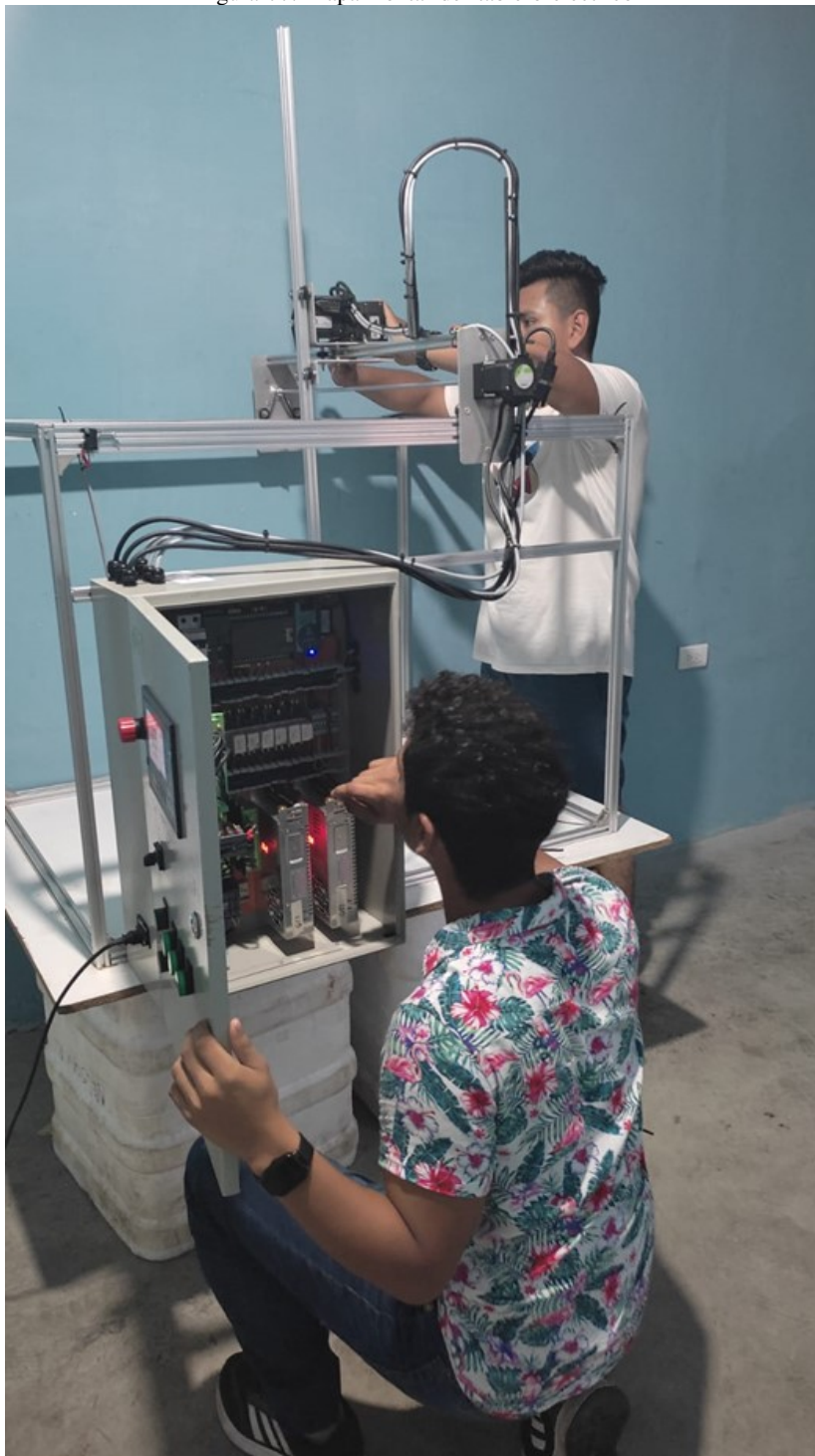
Figura 77. Tapa frontal del tablero eléctrico
