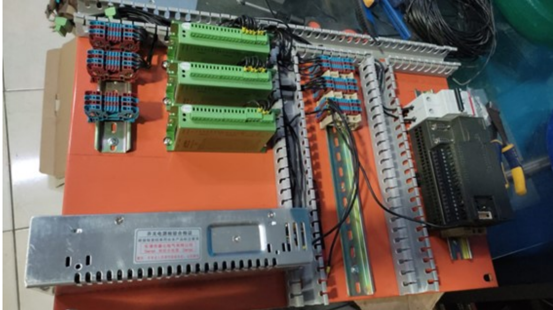
Figura 74. Conexión eléctrica de los drivers dentro del tablero.
