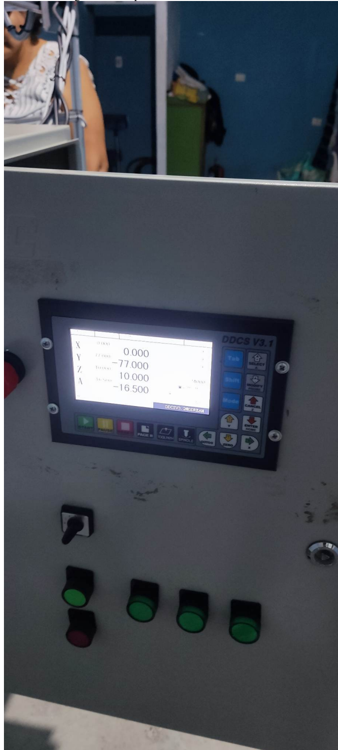
Figura 76. Tapa frontal del tablero eléctrico
