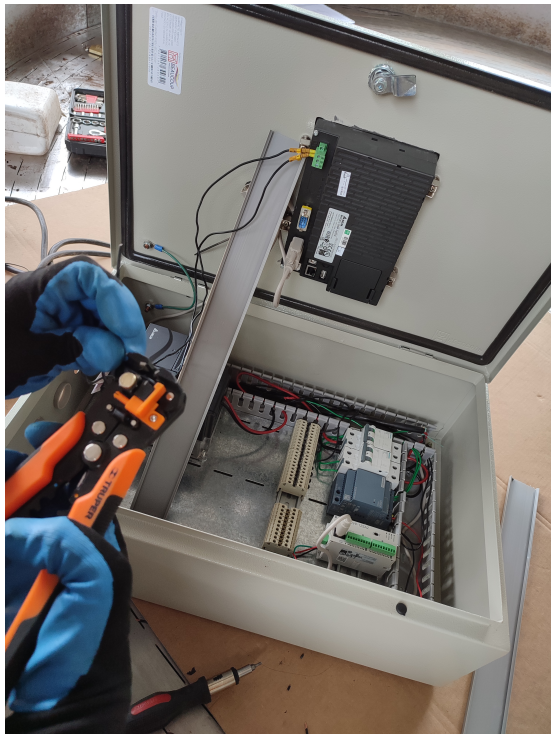
Figura 89. Cableado del HMI [13]
