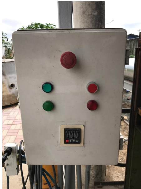
Figura 34. EXTERIOR DEL TABLERO
