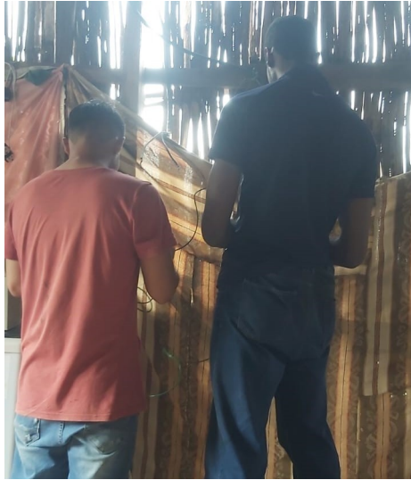
Figura 85. Implementación del tablero de Control
