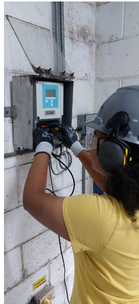
Figura 98: Instalación de sensor de pH Fuente: Autor
