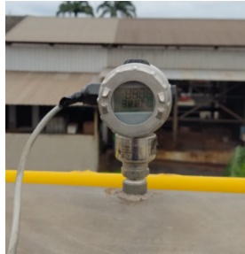
Figura 16: Manómetro digital para biogás - Reactor anaeróbio Fuente: Autor
