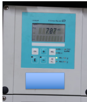
Figura 14: pHmetro - Entrada BTS Fuente: Autor
