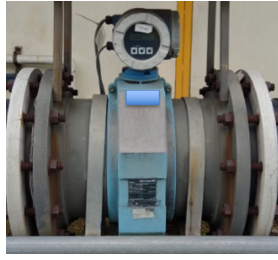
Figura 13: Caudalimetro para agua residual Fuente: Autor
