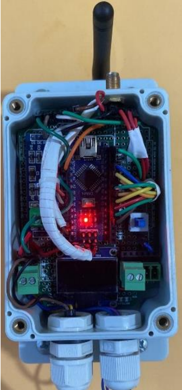
Figura 18: Equipos ya conectados instalados en la caja qBox.
