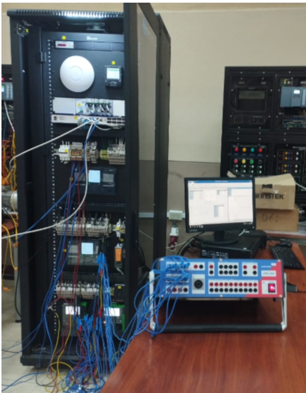
Figura 157: Módulo de relés de protección, Switch industrial Greyhound, RTU Orion LXm, maleta de pruebas Omicron CMC.
