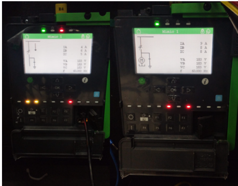
Figura 154: Actuación de las protecciones en los relés Easergy P5.
