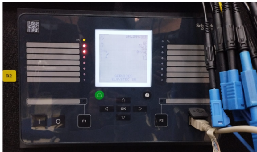
Figura 155: Actuación de las protecciones en el relé P3L30.
