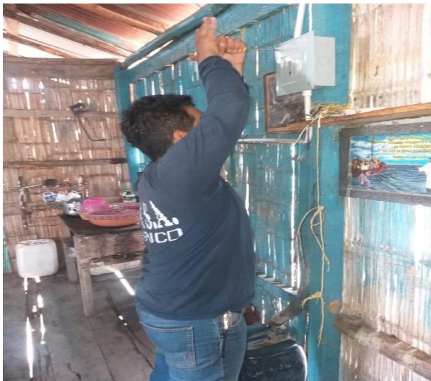
IMAGEN 25. Instalación Panel de distribución.
