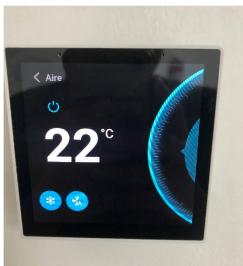
Figura 36. Control de aire acondicionado desde pantalla touch. Fuente: Autores.
