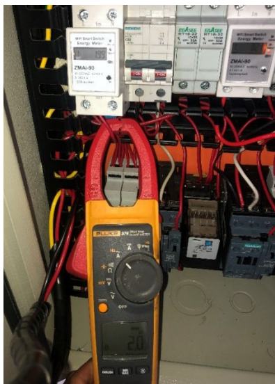
Figura 29. medición de corriente a media carga del sistema de iluminación. Fuente: Autores
