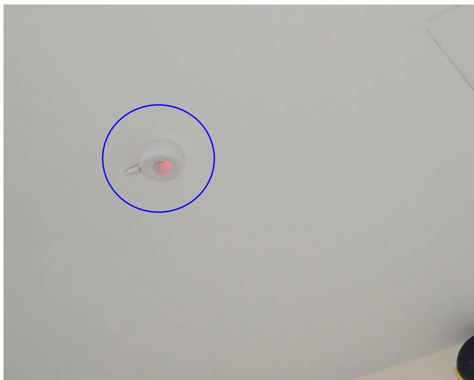
Figura 23. Sensor de movimiento instalado.
