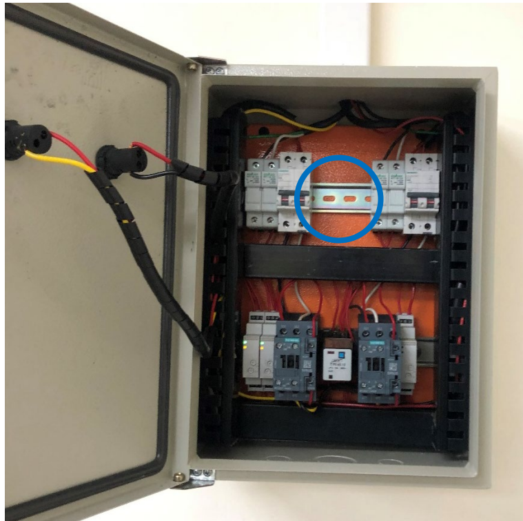
Figura 13. Lugar de instalación de medidores inteligentes; fuente: Autores.
