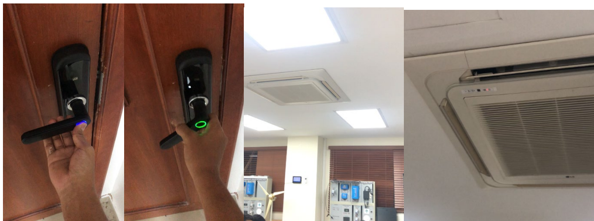
Figura 33. Automatización de encendido mediante cerradura. Fuente: Autores.
