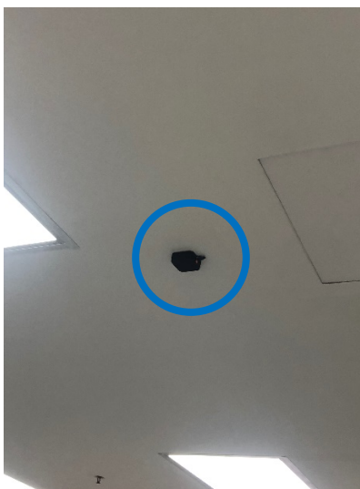
Figura 19. Control remoto infrarrojo y radio frecuencia instalado. Fuente: Autores.
