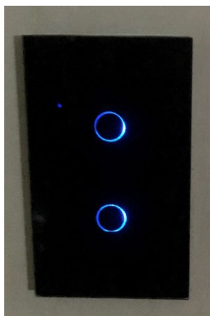
Figura 17. Interruptor inteligente doble vía instalado. fuente: autores.
