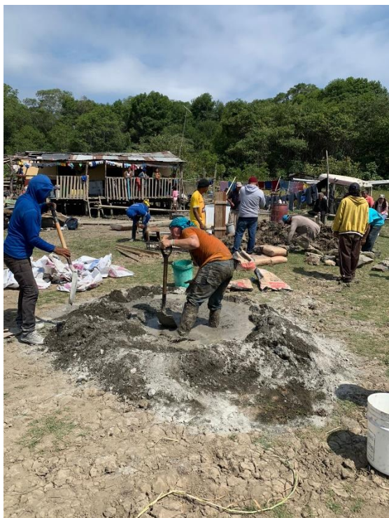
Figura 27 Proceso de elaboración de las bases de los postes de los paneles
