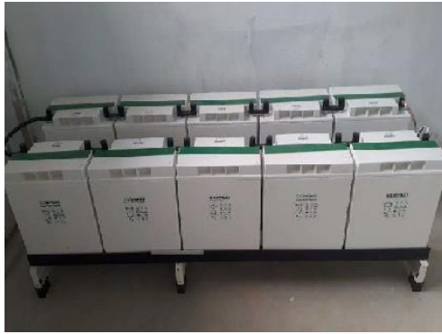
Ilustración 14. Banco de Baterías
