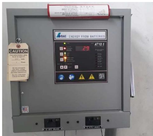
Ilustración 13. Cargador de Baterías
