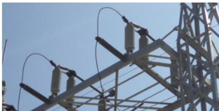
Ilustración 1. Interruptor seccionador 69 kV
