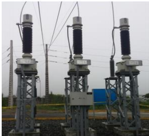
Ilustración 12. Transformadores a medida eléctrico de potencia
