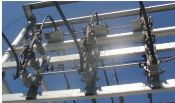
Ilustración 2. Interruptor a 15 kV seccionado con transferencia.
