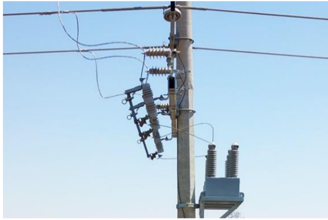
Ilustración 16. Banco de Condensadores Fijos
