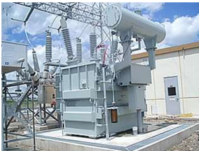
Figura 2.15 :Subestacion de distribucion de energia electrica [18]
