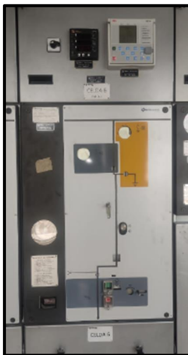
Figura 33: CELDA DE PROTECCIÓN DEL ALIMENTADOR B – Fuente: Autoría
