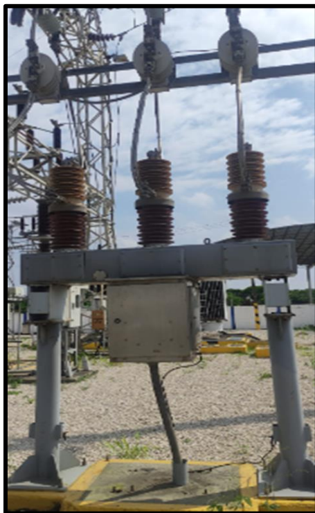
Figura 32: Interruptor principal del transformador A – Fuente: Autoría
