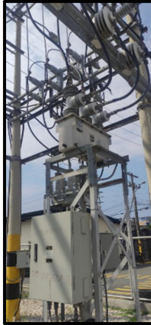
Figura 36: Reconector de Patio B -Ferroviaria – Fuente: Autoría
