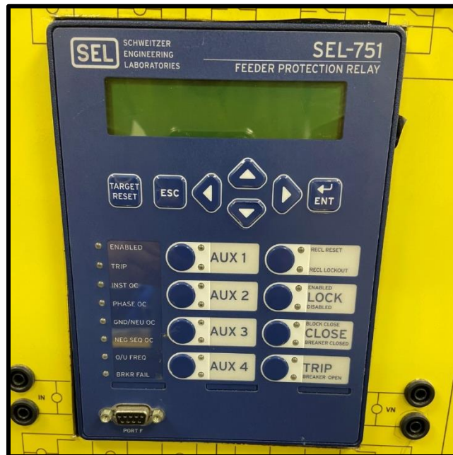
Figura 288: Relé SEL-751 del módulo de protecciones
