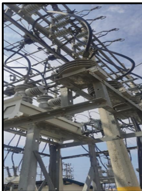
Figura 34: Reconector para alimentador del transformador B – Primavera 2 – Fuente: Autoría
