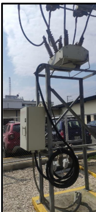
Figura 35: Reconector de Patio B - Centro de Durán – Fuente: Autoría
