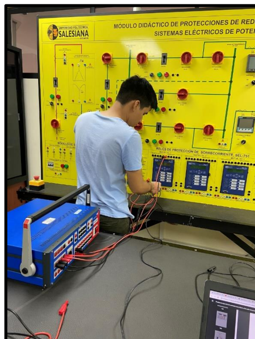
Figura 289: Conexión del cableado del OMICRON CMC 356 al módulo de protecciones
