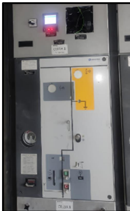
Figura 31: CELDA DE PROTECCIÓN DEL TRANSFORMADOR A – Fuente: Autoría
