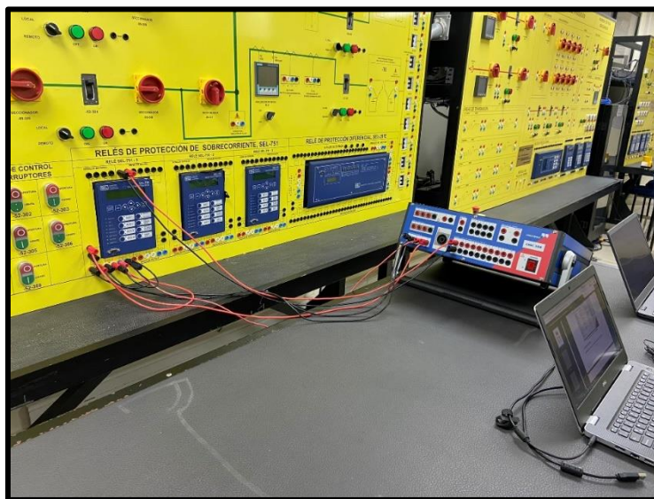
Figura 291: Equipos conectados para las pruebas
