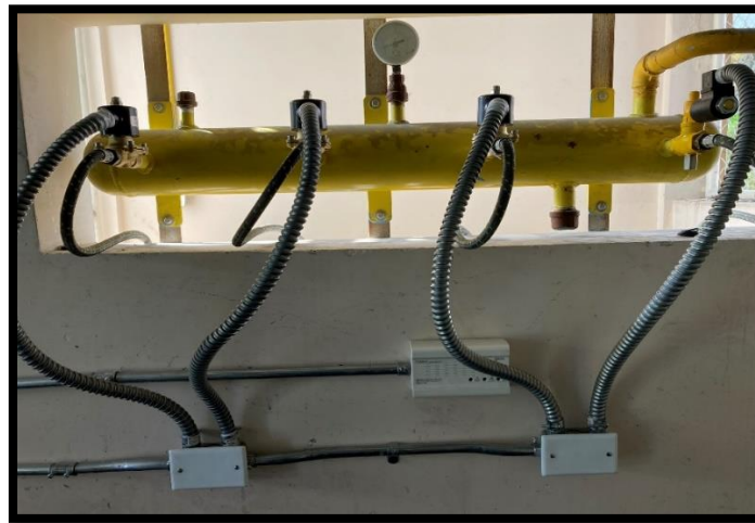
Figura 4.2: Electroválvulas y Sensor instalado
