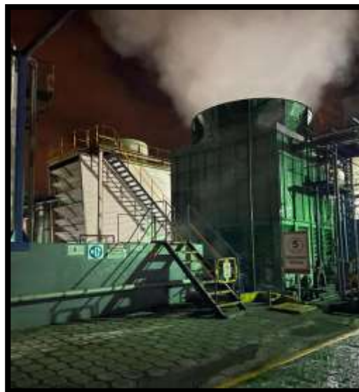
Figura 20 Torre protón antigua junto a la nueva torre de enfriamiento.
