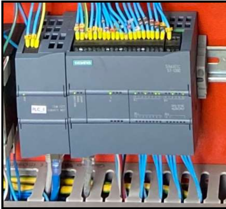
Figura 37 PLC S7-1200 CPU 1214C INSTALDO.
