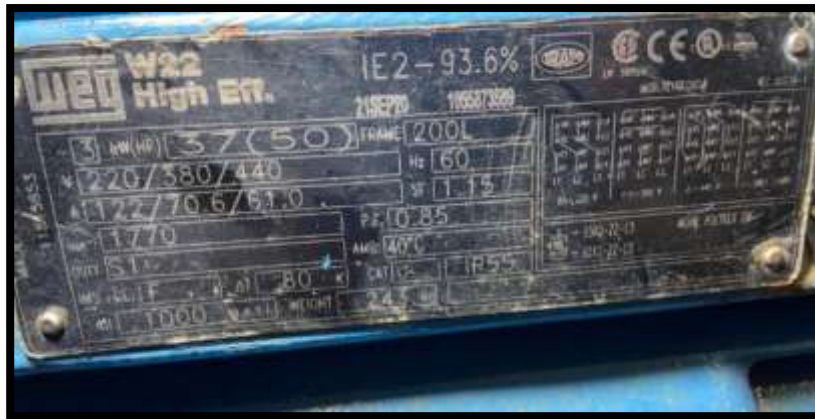
Figura 28 Placa Bomba Torre de enfriamiento 3.
