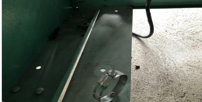
Ilustración 2-7 Tanque y bomba de combustible.
