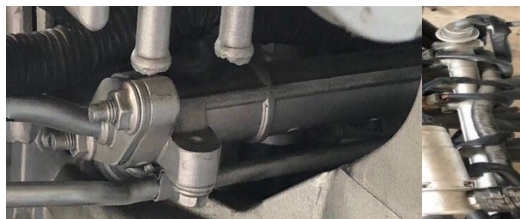
Ilustración 2-4 Cañerías de alta presión.
