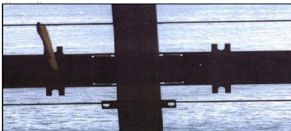
Figura 18 Conexión de momento SLOTTEDWEB. Fuente:
