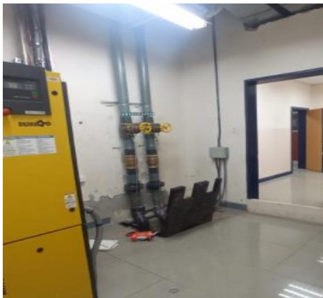
Cuarto de máquinas secundario
