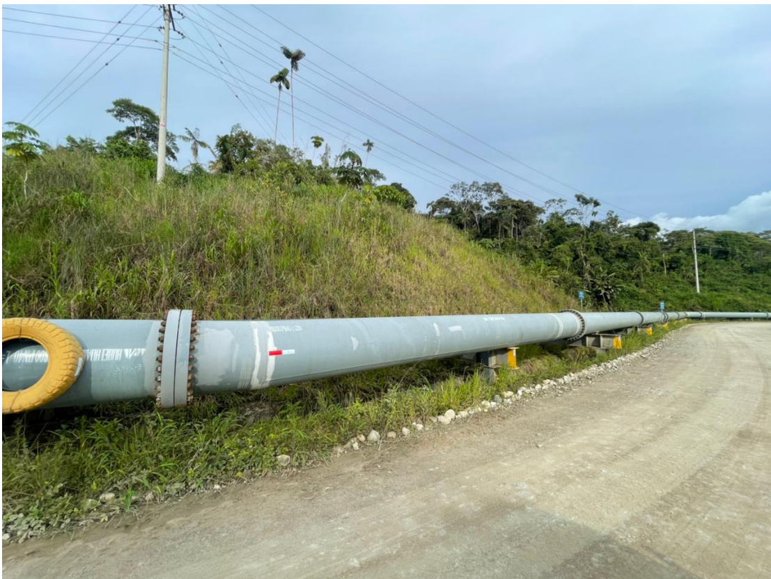
Ilustración 40. Fotografía del tramo identificado como punto crítico M8 de la tubería de descarga de relaves del proyecto Mirador.
