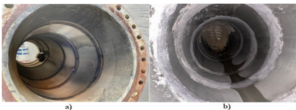
Ilustración 8. Tubería modificada a) sin recubrimiento b) con recubrimiento epóxico cerámico.
