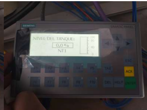
(d) Visualización Nivel del Tanque.
