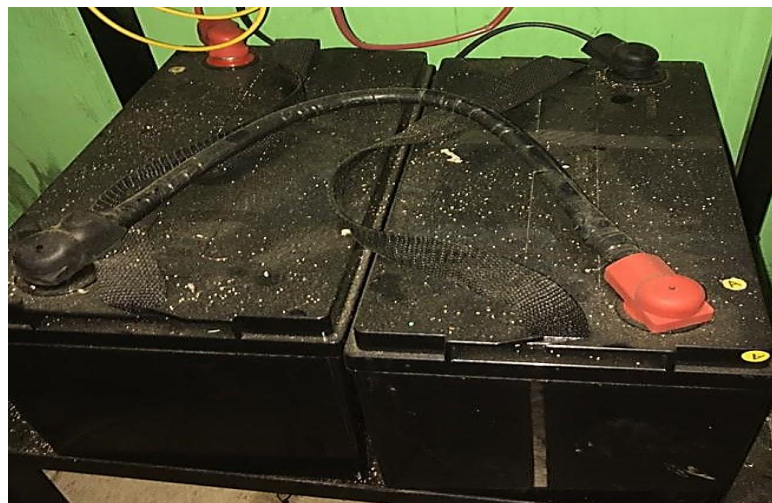
Ilustración 13 - Baterías en sitio Fuente: Autores
