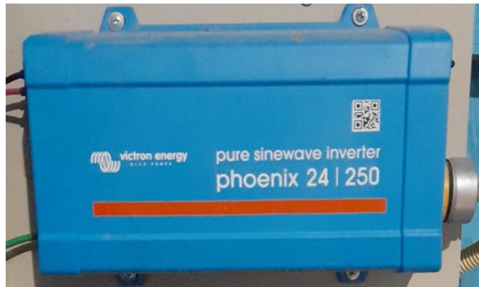
Ilustración 15 - Inversor en sitio Fuente: Autores
