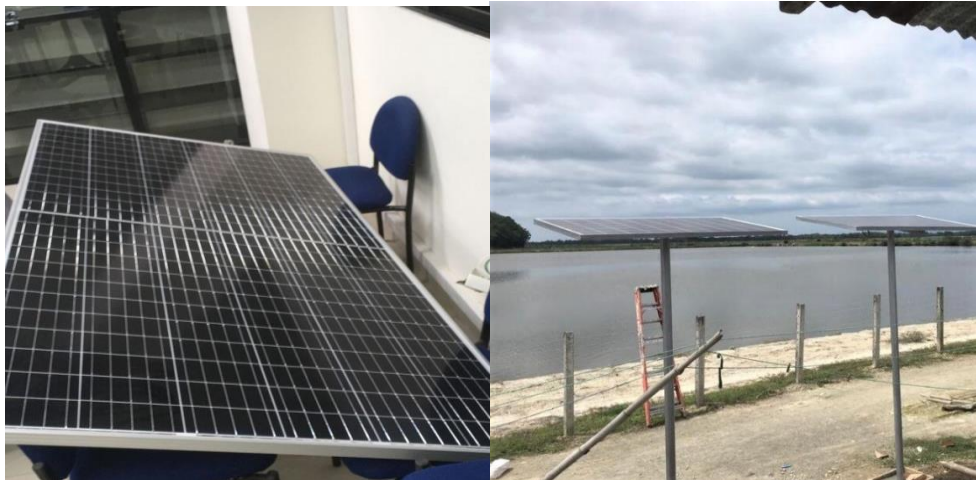
Ilustración 10 - Paneles fotovoltaicos instalados Fuente: Autores
