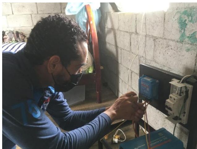
Ilustración 62 - Conexión de todos los Equipos Fuente: Autores
