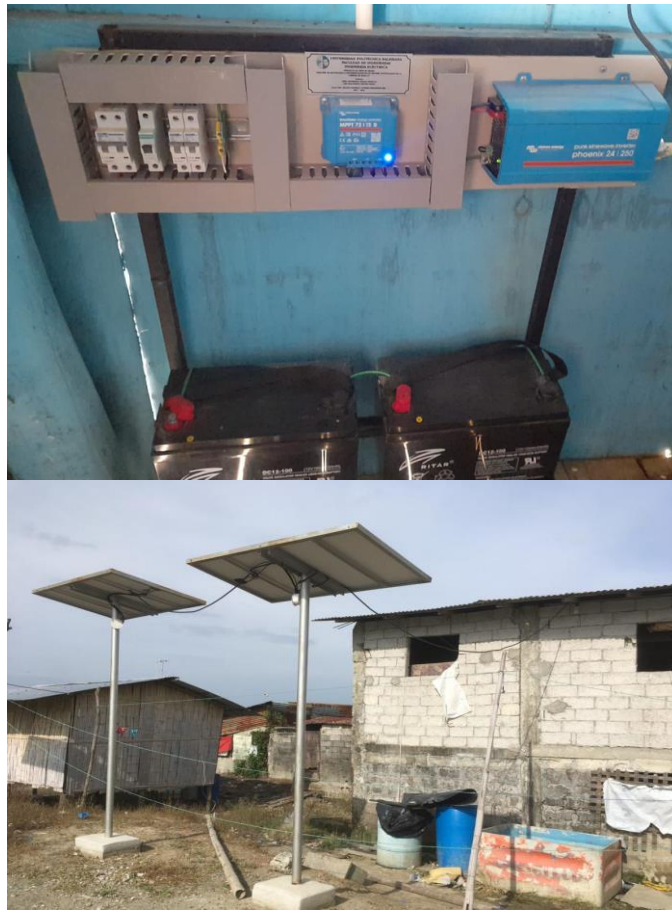
Ilustración 63 - Equipos instalados Fuente: Autores
