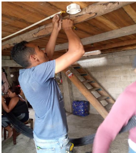
Ilustración 44 - Cableado Eléctrico para circuito de luminaria Fuente: Autores.
