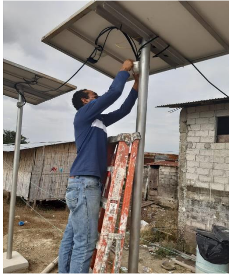
Ilustración 61 - Conexión en serie de los paneles solares Fuente: Autores
