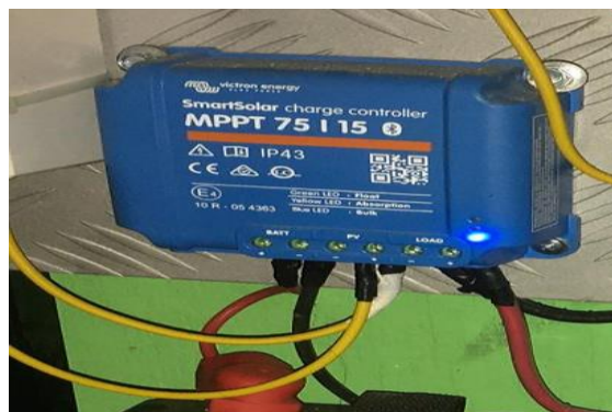
Ilustración 12 - Controlador de carga en sitio Fuente: Autores
