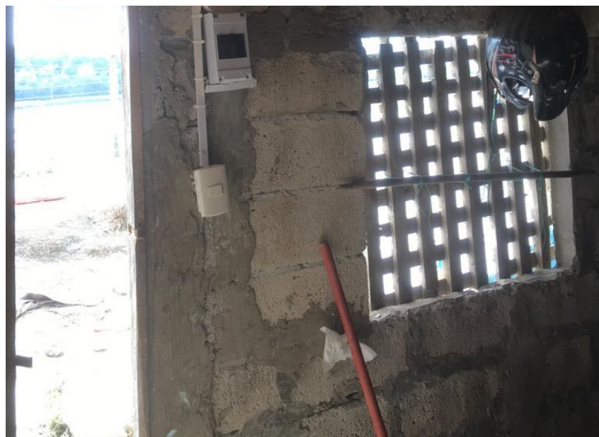
Ilustración 41 - Panel de disyuntores instalado Fuente: Autore
