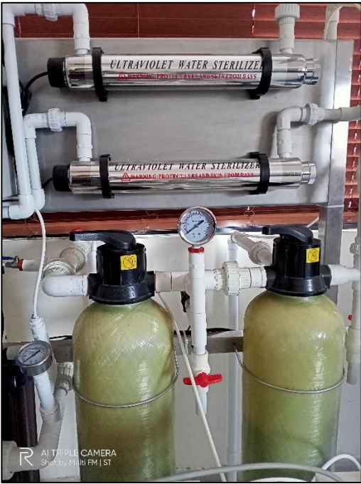
Fig. 60 Filtros de zeolita, carbono activado y ultravioletas
