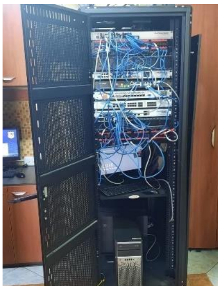
Figura 3.3 Rack mantenimiento técnico e informático de 36 U
