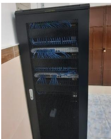
Figura 3.4 Rack principal cuarto de telecomunicaciones informática 28 U
