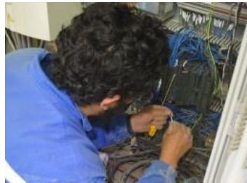
Figura 4.18: Interconexión de señales en el tablero G206.
