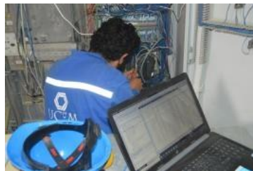
Figura 4.19: Verificación de cableado en el tablero G206.
