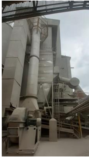
Figura 3.1: Emplazamiento físico del sistema secador
