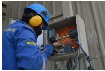
Figura 4.17: Interconexión de señales en el tablero de control de disparo del filtro.
