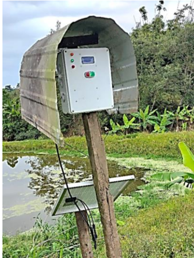
Figura 3.26 Estación fija Instalada.
