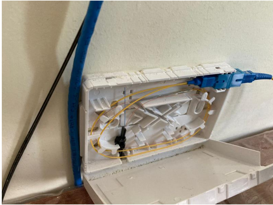
Figura 55. Caja de fibra óptica.
