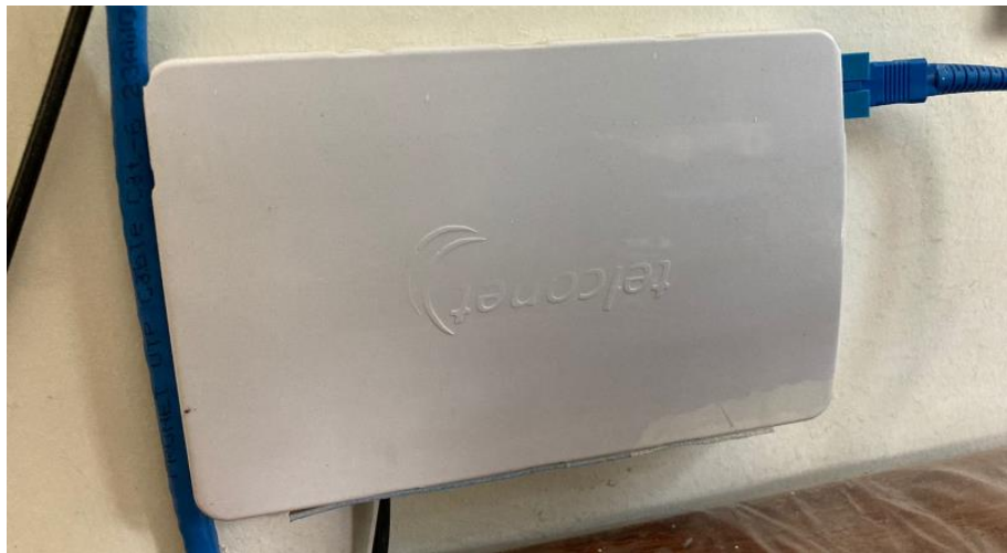
Figura 54. Caja de fibra óptica.
