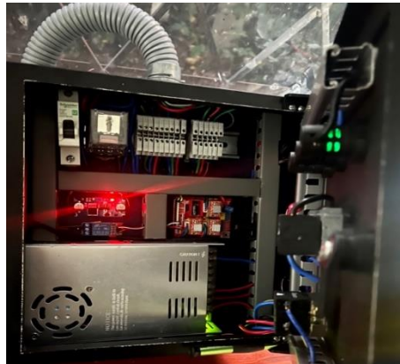
Figura 68 - Tablero de control finalizado.
