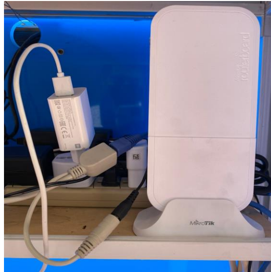
Figura 6.6: Implementación de un Gateway LoRa
