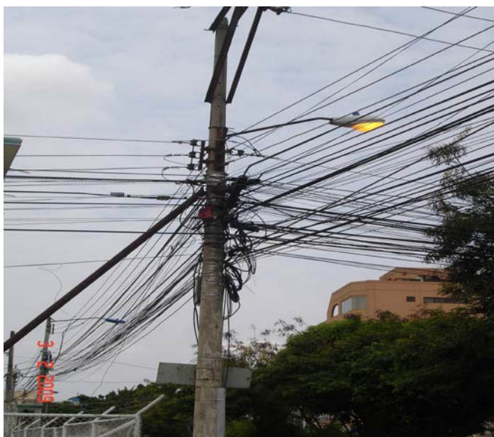
Figura 5.2: En esta foto se observa claramente el desorden una gran cantidad de cables. Fuente: Autora
