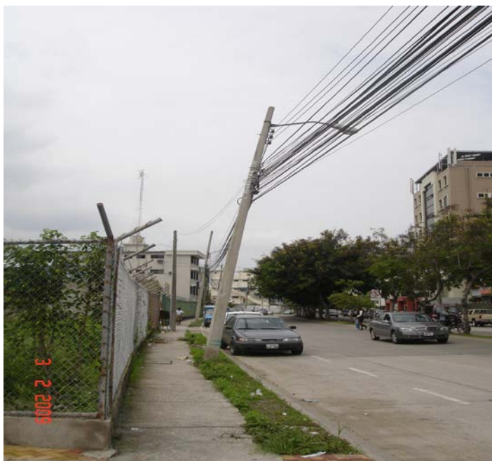
Figura.5.1: .Muestra un poste a punto de caerse por la cantidad de cables puestos sobre este.
