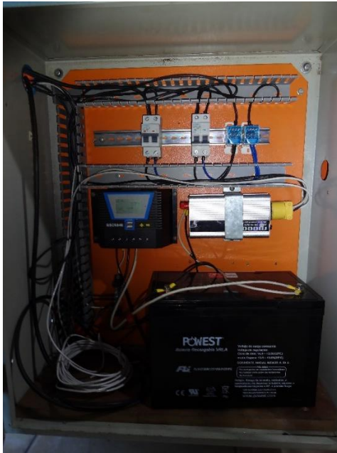
Anexo 9 Instalación batería
