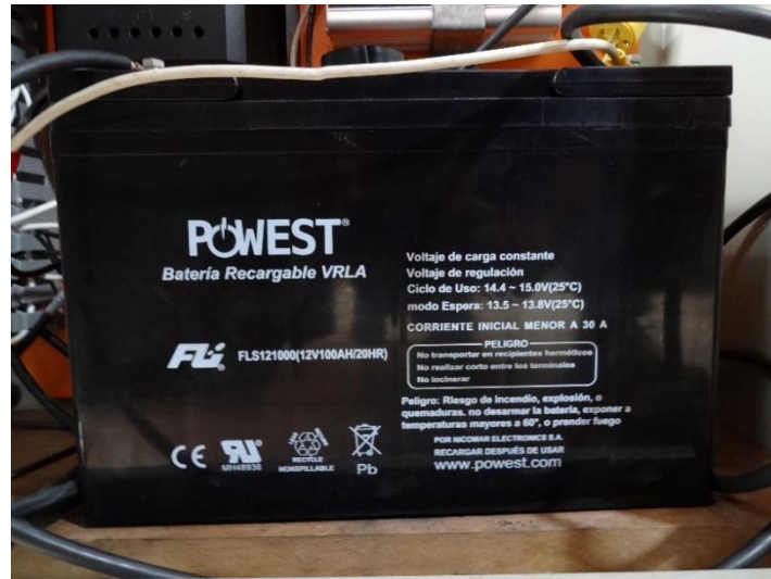
Figura 9. Batería sellada. Fuente: Autor
