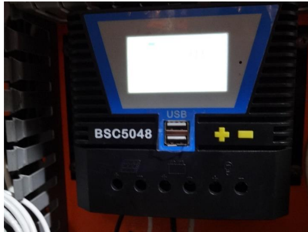
Figura 8. Regulador de carga. Fuente: Autor
