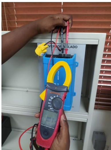
Ilustración 41. Medición del voltaje de salida del inversor
