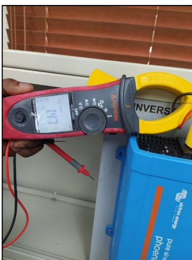
Ilustración 40. Medición de corriente del inversor a vacío
