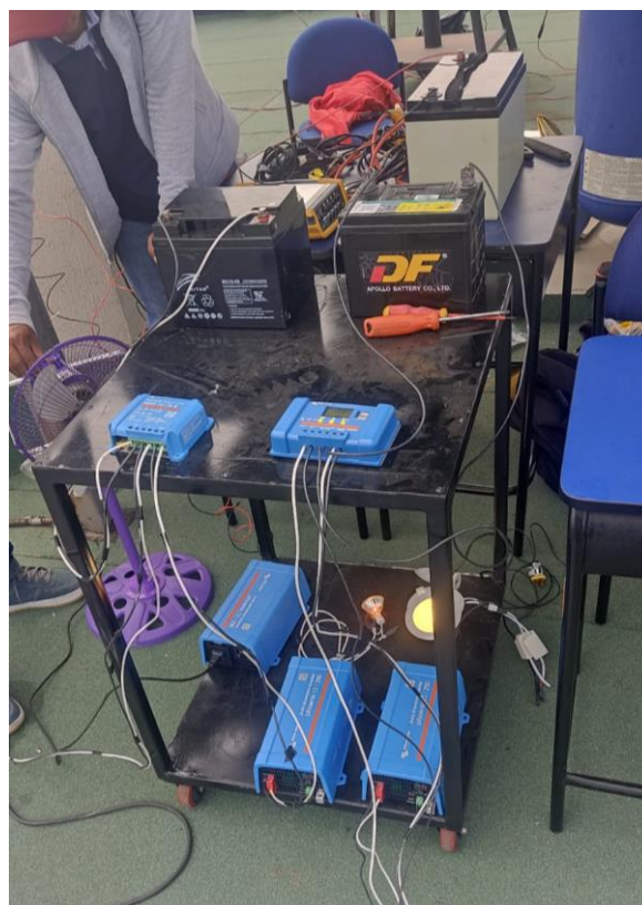
Ilustración 24: Prueba preliminar de funcionamiento de los equipos
