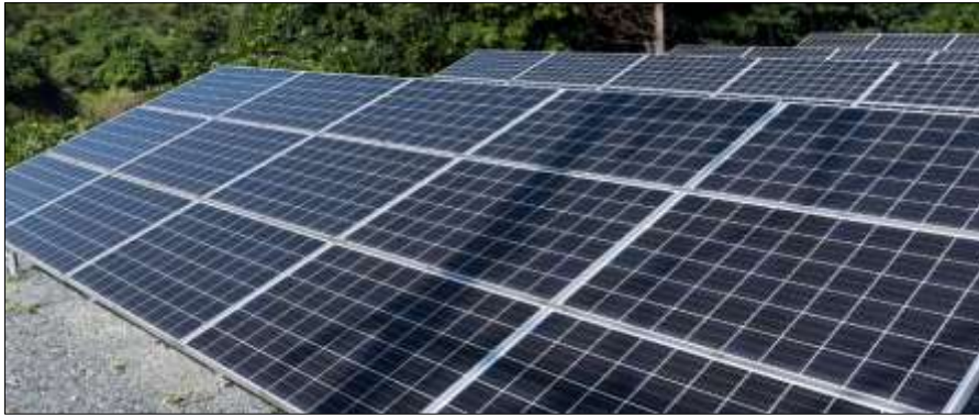
Ilustración No. 21: Paneles solares afectados por sombras
