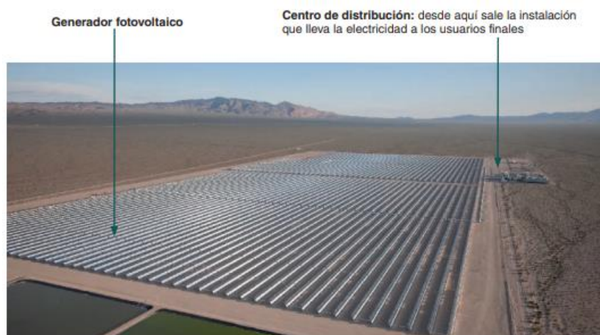
FIGURA. 10 CENTRAL FV SEPARADA EN EL DESIERTO DE NEVADA (ELEC_01)
