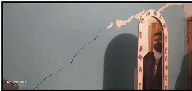
Fotografía 7: Fisura de paredes
