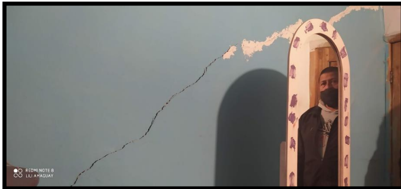
Fotografía 7: Fisura de paredes
