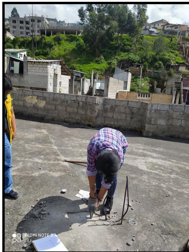
Fotografía 16: Impacto de martillo en losa
