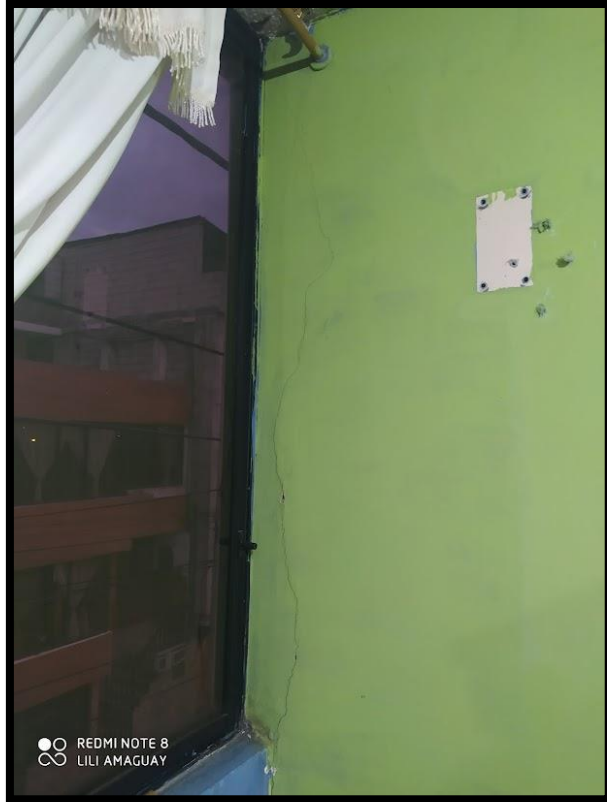
Fotografía 11: Desplazamiento de ventanas
