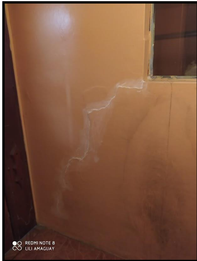
Fotografía 10: Fisuras en paredes
