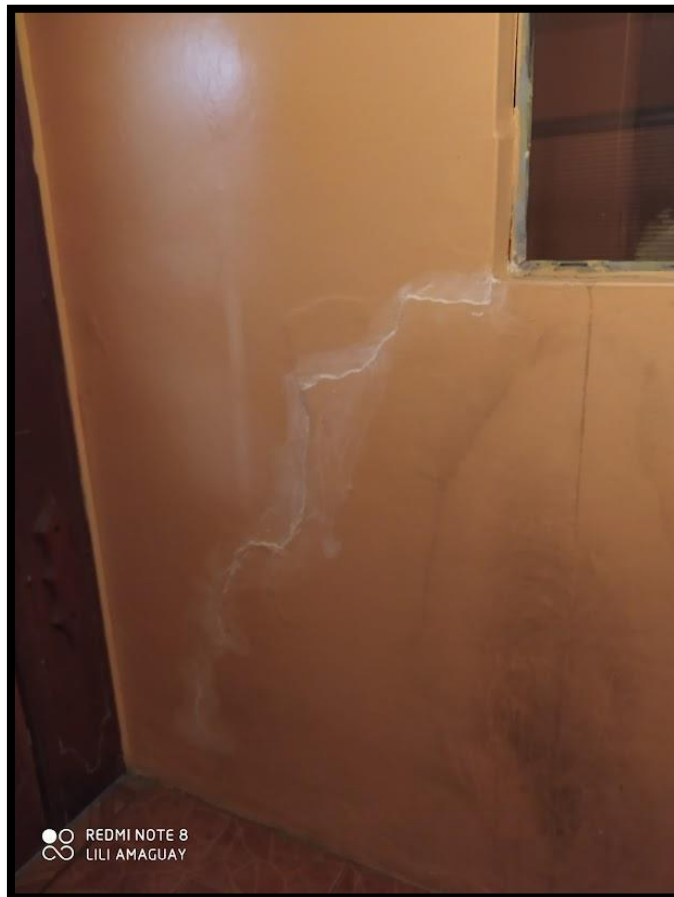
Fotografía 10: Fisuras en paredes
