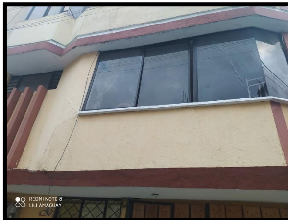
Fotografía 8: Fisura en ventanas
