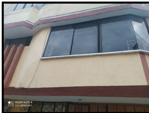
Fotografía 8: Fisura en ventanas
