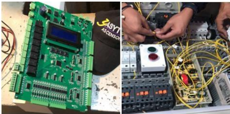
Figura 15. Tarjeta de control de marca ASYTEC y conexión de partes electrónicas y medidor de voltaje. Los autores
