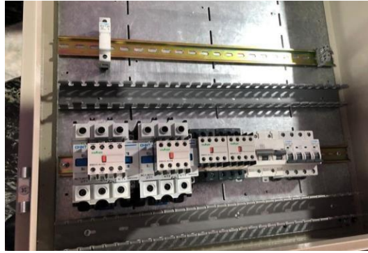
Figura 14. Caja de control con contactores y portafusibles. Los autores
