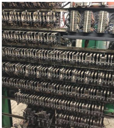
Figura 8. Tablero de control con bobinas y contactores. Los autores
