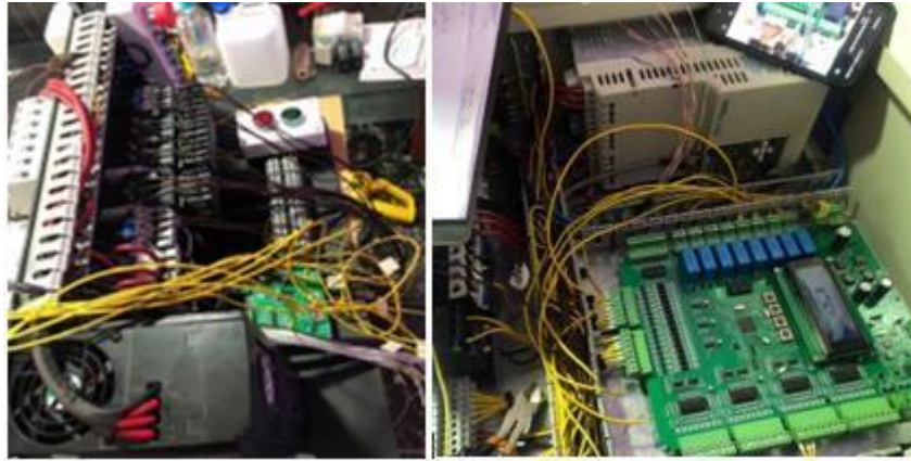
Figura 16. Conexión de fuentes, conexión de variador y tarjeta central. Los autores
