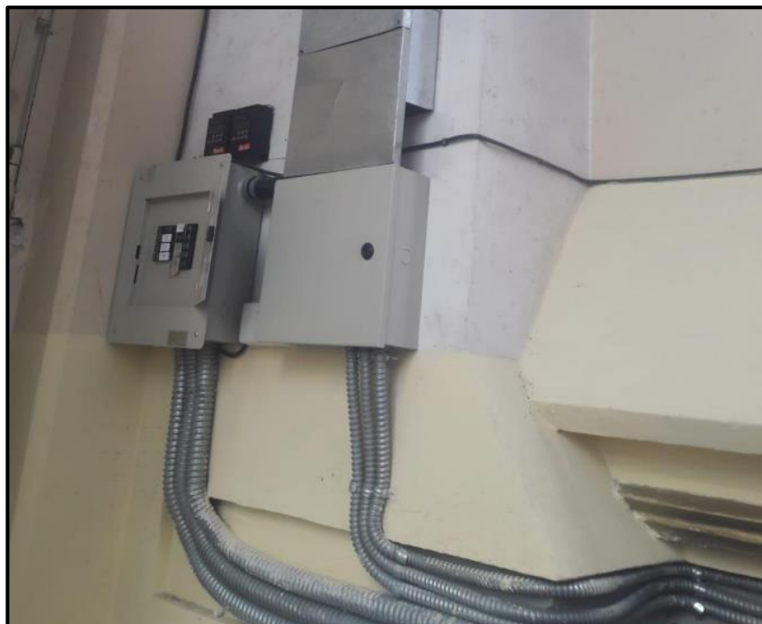
Anexo 26 Tableros de circuitos secundarios
